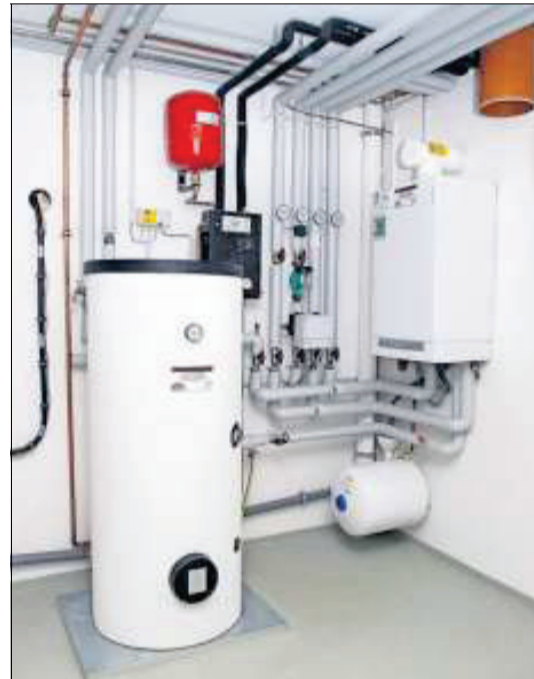
Mit effizienten Gas-Brennwertkesseln lässt sich viel Energie sparen
